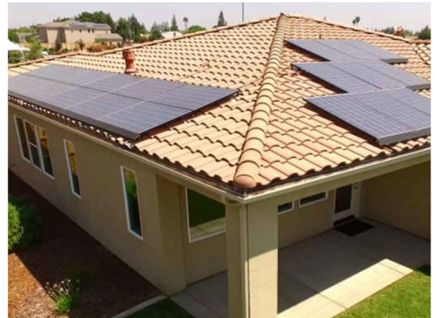
Mesken Çatısı GES Uygulamaları
