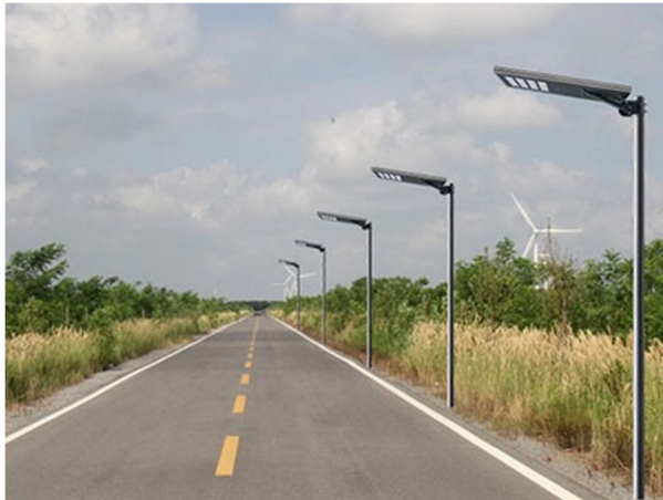
Sokak Aydınlatma GES Uygulamaları
